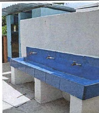
Foto 4: Lavamanos en funcionamiento.
