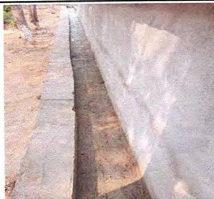
Foto 2: Cuneta en la parte baja.
